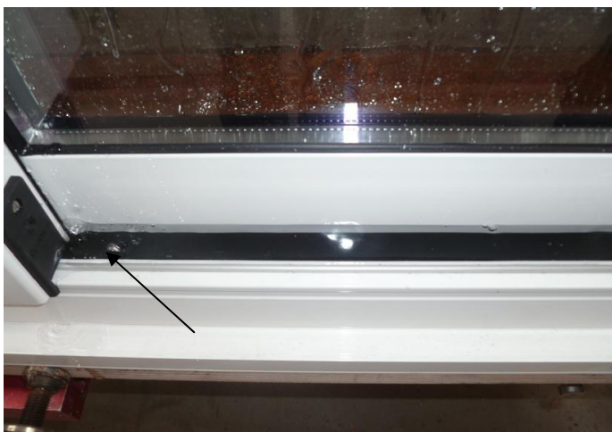
Débordement de la garde d'eau
